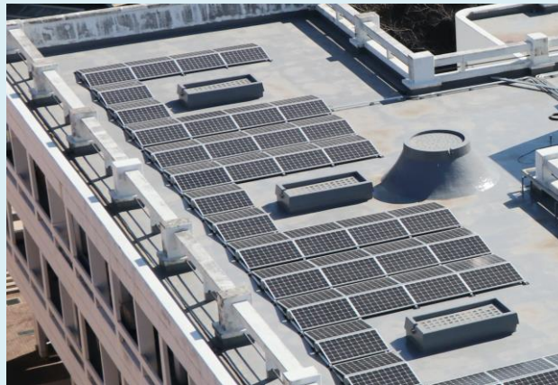
3号館屋上(パネルは東西向き傾斜10度)
