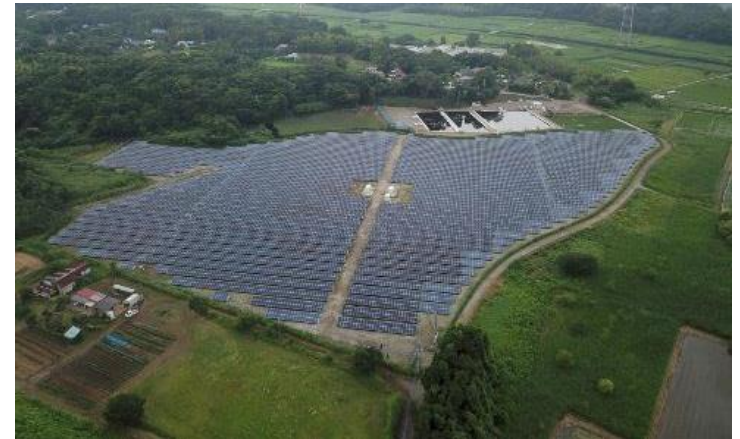
野田メガソーラー (2.45MW⇒2.88MW増設後) ・縁の部分、色がうすくみえるのが増設パネル ・発電量 3,635,263 kWh (2018.4-2019.3) (増設前12ヶ月発電量より16.9%アップ)
