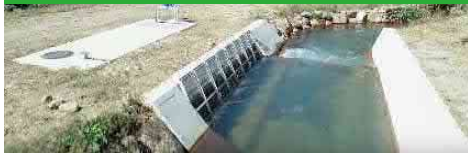
小水力発電所
