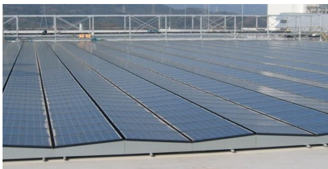
ビル屋上平面設置 (最大発電量、省エネ)
